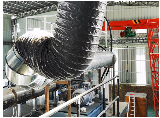
废气收集管道
